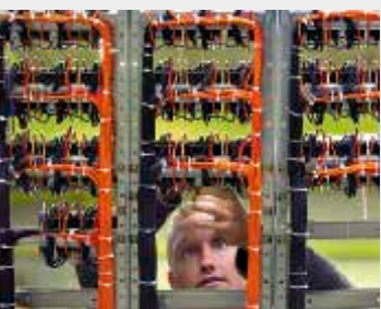
Ohne Kabelschrank kein Netz.
